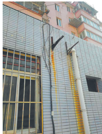
出现打火现象的电线。记者周朝晖
