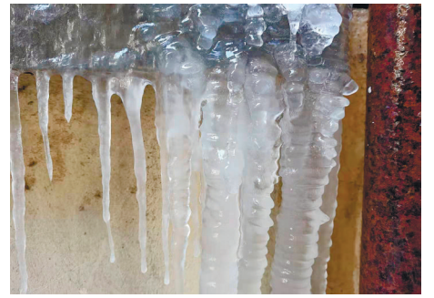
市区一居民家中自来水管漏水,因天冷形成小冰柱。 记者尤炼
