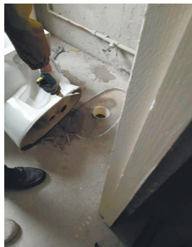
技术人员正在张女士家中检查马桶。 记者周朝晖
