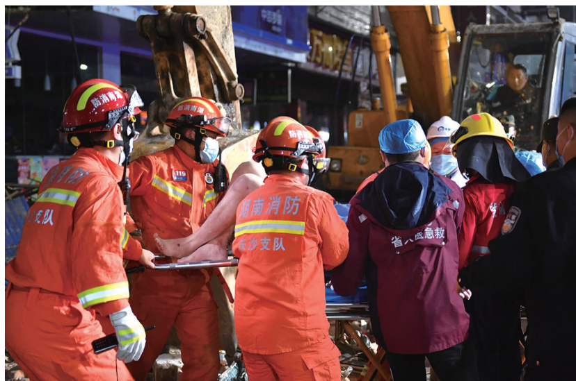
4月29日,一名被困者被消防救援人员从长沙居民自建房倒塌事故现场救出,随后被送往医院救治。 新华社发
