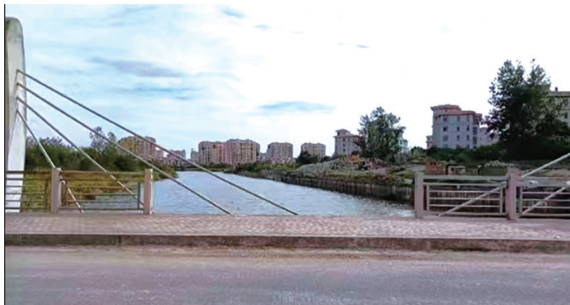
涉事桥梁护栏损坏。(资料图)
