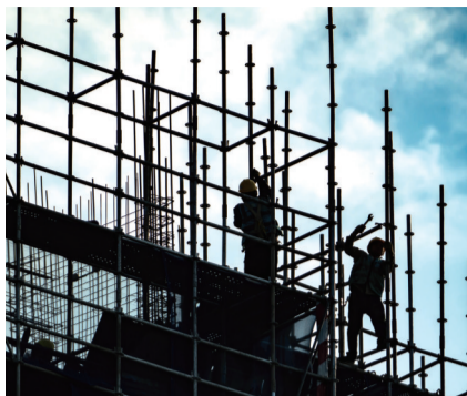
▲支撑 4月25日,南通创新区一建筑工地,脚手架上的施工人员。冯周鼎
