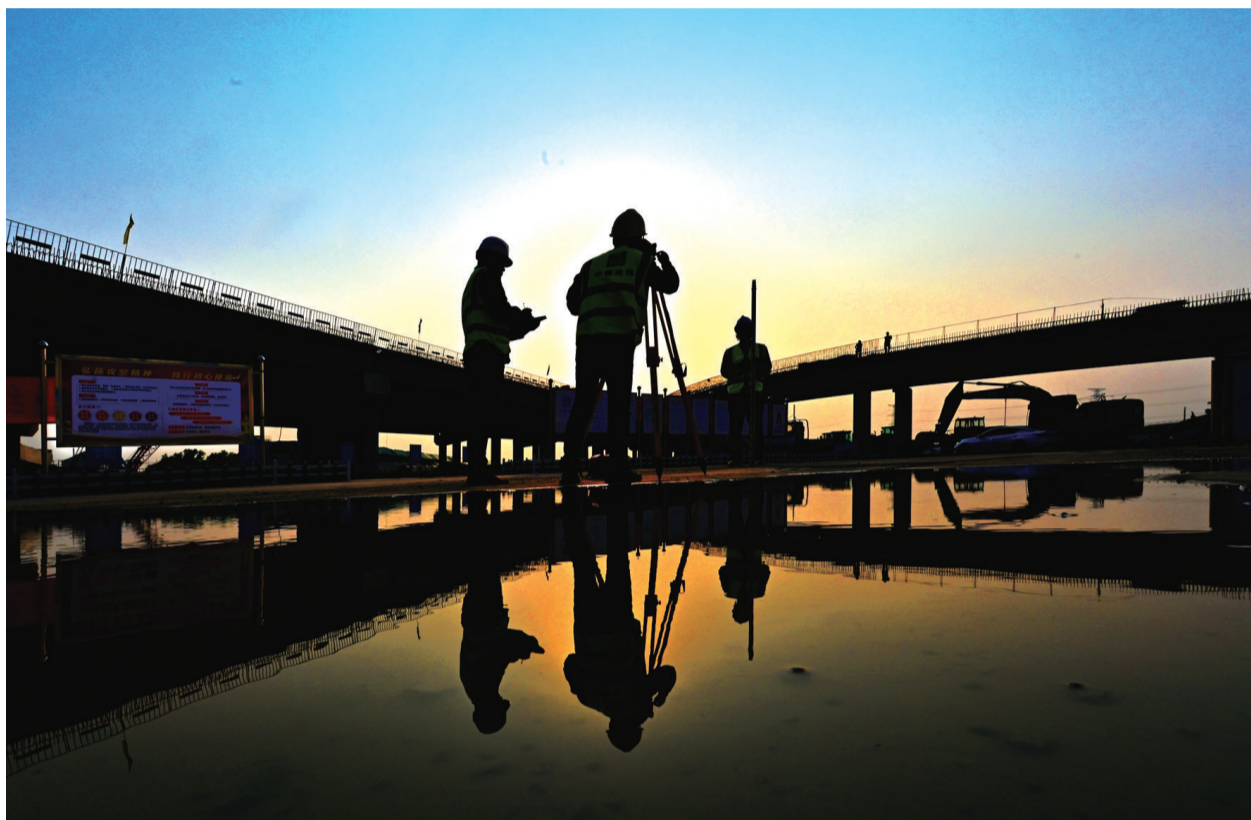
▲测量 四月二十六日,绕城高速骑岸枢纽建设工地,施工人员在测量。丁传彬
