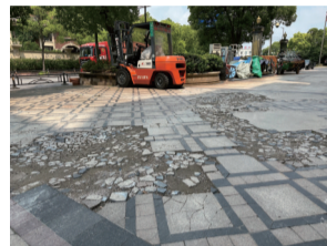
地砖破损。记者张园
