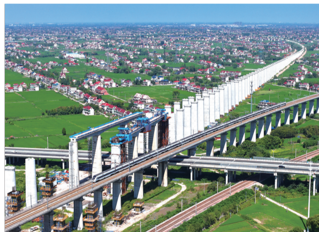
昨天在通州区辖区拍摄的北沿江高铁跨通锡高速施工现场。目前,北沿江高铁江苏段多个控制性节点工程有序推进。 记者许丛军
