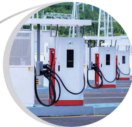
四川元启星光重卡兆瓦超充站——华为兆瓦超充设备。
