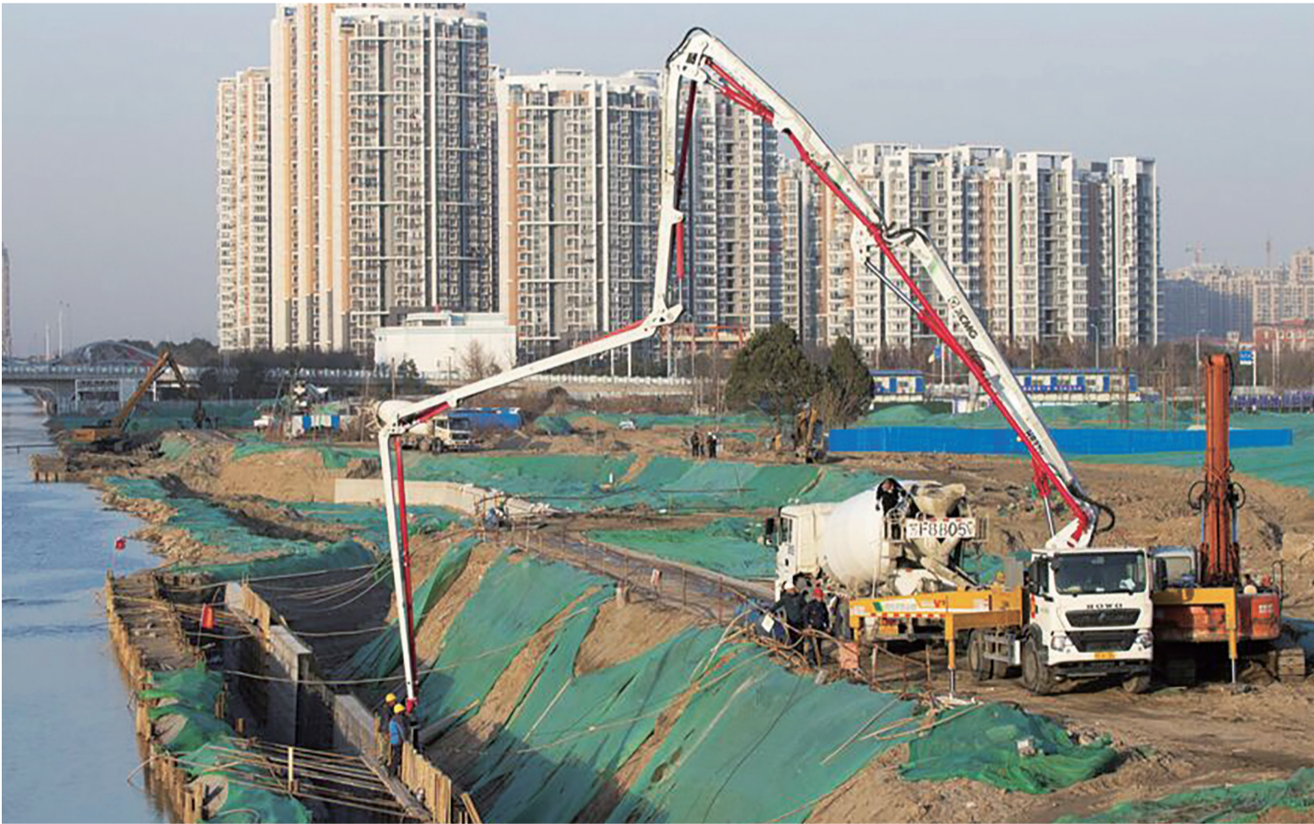
昨天,海港引河东侧绿廊河道景观护坡正紧张施工中,该工程位于江中路高架至观阳路,将建成我市生态圈中又一处供市民休闲娱乐的城市氧吧区。 钱伟章摄
