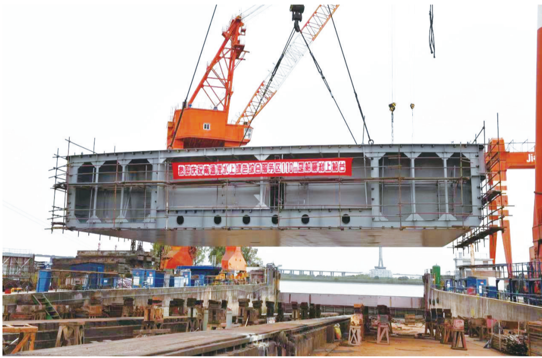
6日下午,南通港水上绿色综合服务区110米趸船顺利运上船台,随后从专用船台上缓缓滑入江中,在拖轮协助下顺利靠泊船厂内装码头。船舶首尾是整船建造重要节点,标志该船舶船体建造工程已完工,进入设备安装调试和内装阶段。 严春花文 陆伟程摄
