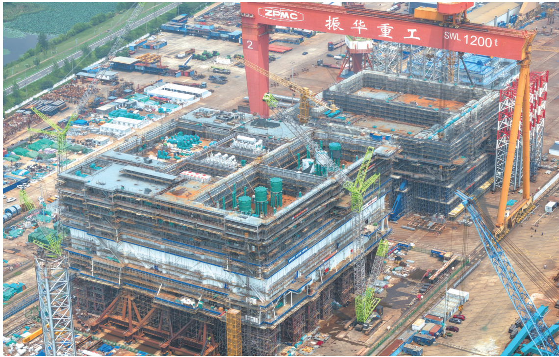
5日,南通振华重装±500kV海上换流站项目现场,工人们正在忙碌施工。该项目为7层钢结构平台,总重约为27216吨,预计9月封顶。 记者 许丛军摄
